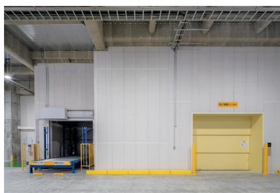
貨物用エレベーター
